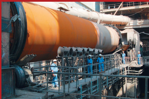
Ofen des südindischen ZEMENTWERKS AMMASANDRA, 2008.
