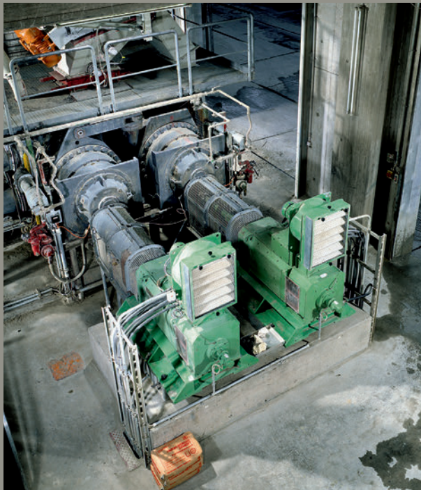
GUTBETTWALZENMÜHLE im Zementwerk Schelklingen, 2000.
