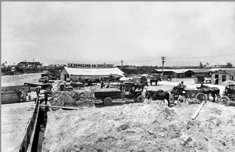
ANLIEFERUNG VON FRISCHBETON auf eine Baustelle durch die amerikanische Firma I. E. Schilling, um 1915.
