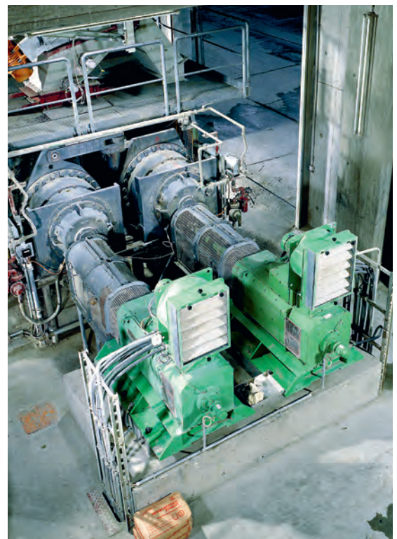
Gutbettwalzenmühle im Zementwerk Schelklingen, 2000
