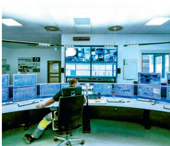
Die Anlagensteuerung verläuft heutzutage vollständig digital, hier im Werk Lengfurt, ca. 2020.
